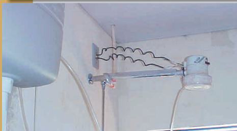
Goiatuba – Vista interna do banheiro e instalações hidráulicas da água aquecida, proveniente do coletor solar.
