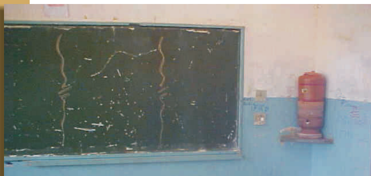
Este é o aspecto geral das salas de aula, apresentando umidade nas paredes e desgastes na pintura.
