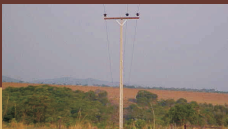
Estrutura empenada (fora de prumo) N1 n.º 21024959 (necessário fazer correção).
