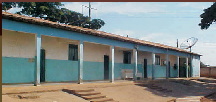
Bloco com 5 salas de aula e administ., que até o momento não passou por nenhum reparo, prejudicando o andamento das aulas.
