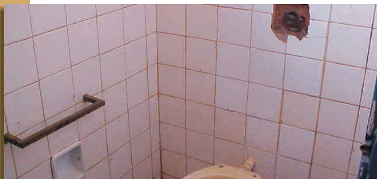
Não foram substituídas as válvulas estragadas dos sanitários e a descarga é feita com baldes de água.
